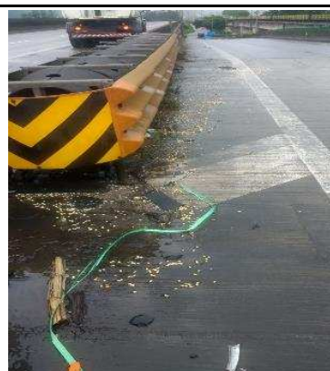
Foto 70 SP 150 Km 43,200 Sul Varrição e Capinagem Data da Constatação 22/05/17
