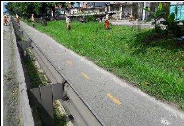
Foto 9 SPA 248 Km 4,000 Leste Roçada Manual Data da Constatação 23/05/17
