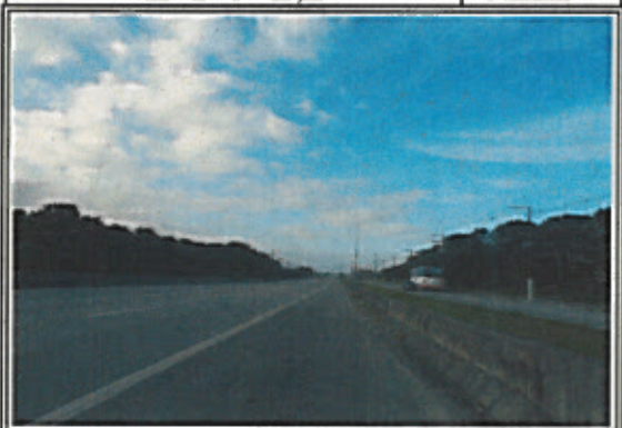
FOTO 03: SP-055 PMN - Km 284+600 ao 284+500 Leste
