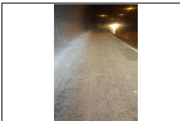
Foto 42 SP 055 Km 271,000 Leste Varrição e Capinagem Data da Constatação 22/05/17
