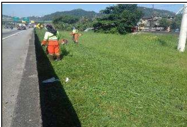
Foto 58 SP 150 0 64,000 Sul Roçada Manual Data da Constatação 17/05/17
