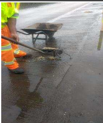
Foto 67 SP 150 Km 40,000 Sul Varrição e Capinagem Data da Constatação 22/05/17
