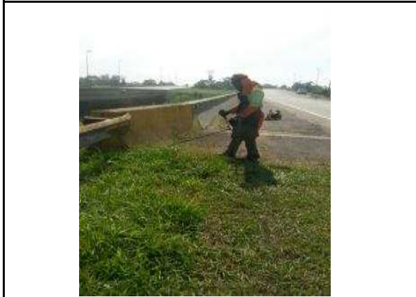
Foto 7 SPI 040 Km 1 ao 8 Leste Varrição e Capinagem Data da Constatação 10/05/17
