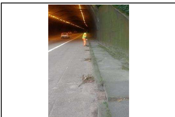
Foto 41 SP 055 Km 272,500 Leste Varrição e Capinagem Data da Constatação 22/05/17
