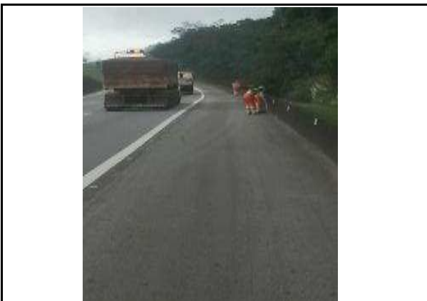
Foto 5 SPI 040 Km 1 ao 8 Leste Varrição e Capinagem Data da Constatação 10/05/17
