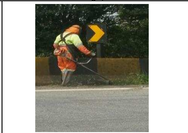
Foto 8 SPI 040 Km 1 ao 8 Leste Varrição e Capinagem Data da Constatação 10/05/17
