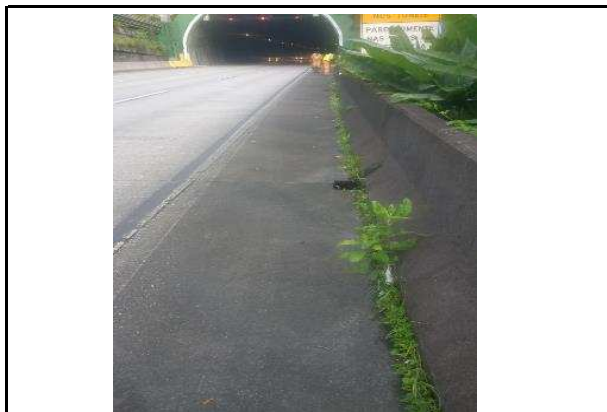
Foto 2 SP 160 Km 59,000 Sul Varrição e Capinagem Data da Constatação 02/05/17
