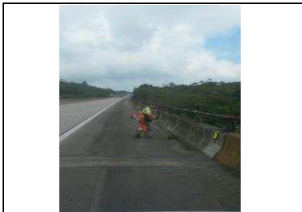
Foto 6 SPI 040 Km 1 ao 8 Leste Varrição e Capinagem Data da Constatação 10/05/17
