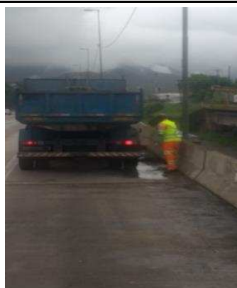
Foto 68 SP 150 Km 42,000 Sul Varrição e Capinagem Data da Constatação 22/05/17
