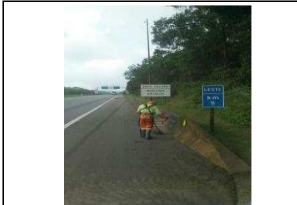
Foto 4 SPI 040 Km 1 ao 8 Leste Varrição e Capinagem Data da Constatação 10/05/17
