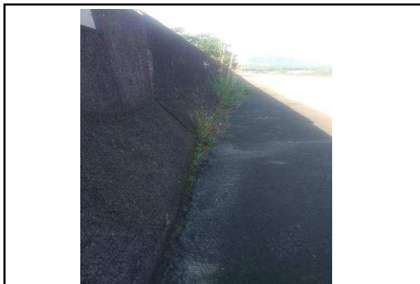
Foto 4 SP 055 Km 55,000 Sul Varrição e Capinagem Data da Constatação 02/05/17
