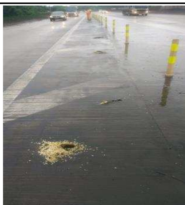
Foto 69 SP 150 Km 43,000 Sul Varrição e Capinagem Data da Constatação 22/05/17
