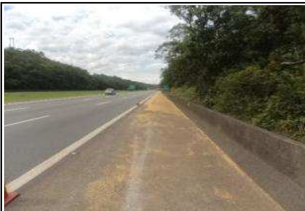
Foto 1 SPI 040 Km 3+000 Leste Limpeza Acostamento Data da Constatação 28/04/17
