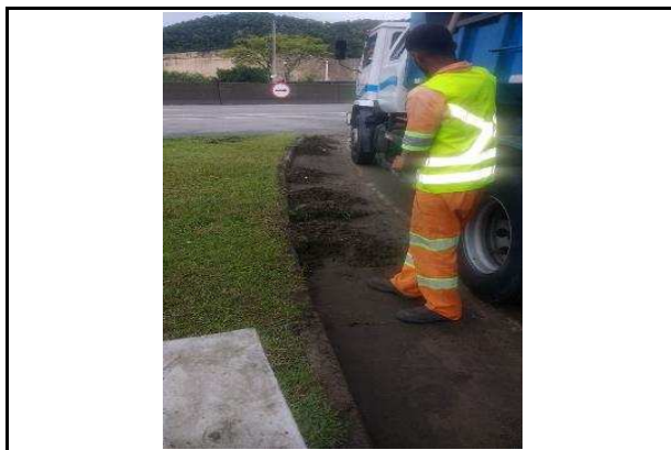
Foto 40 SP 055 Km 272,000 Leste Varrição e Capinagem Data da Constatação 22/05/17
