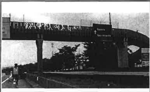
Remoção de Pichaço - Antes SP-160 - Km16+629
