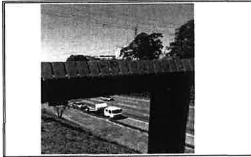
Remoção de Pichação - Antes SP-160 - Km13+589
