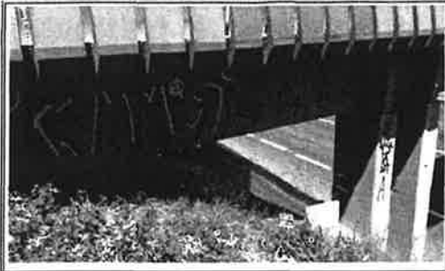
Remoção de Pichaço - Antes SP-150 - Km16+230
