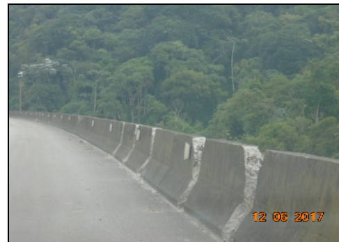
SP-021, km 85+200, pista interna – trecho em obras sem sinalização – constatado em 12/06/2017 e verificado novamente em 27/06/2017
