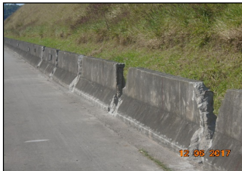
SP-021, km 79+000, pista externa – trecho em obras sem sinalização – constatado em 12/06/2017 e verificado novamente em 27/06/2017
