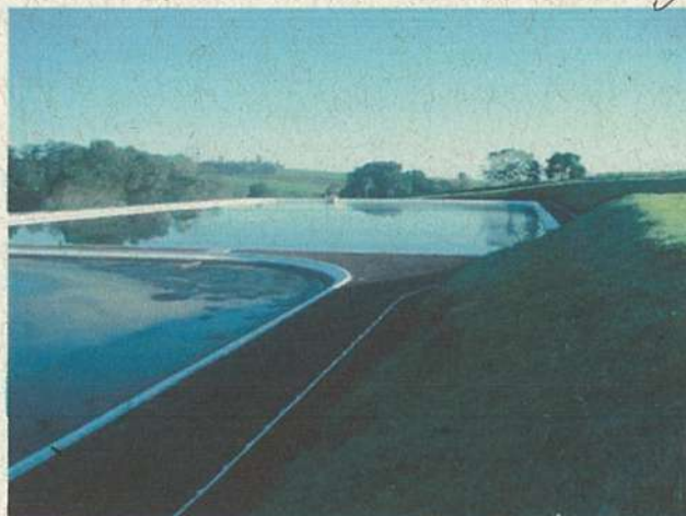
Imagem 03 – Estação de tratamento de esgoto
