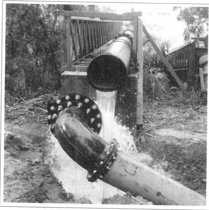
Figura 2 - Rompimento do flange de ferro fundido, de 400 mm de diâmetro do trecho reto.
