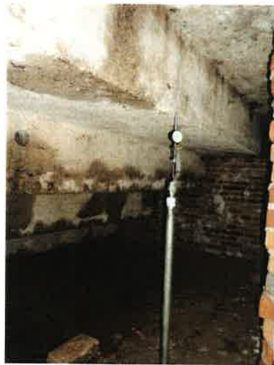
Figura 32 – Detalhe da instrumentação instalada no patamar da arribancada.
