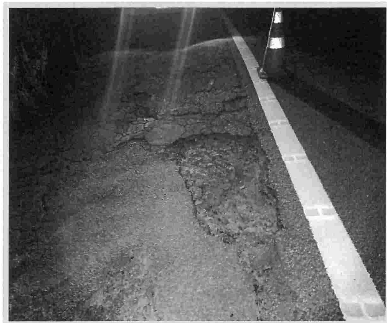
Foto 34 – SP 125 – Km 55,300m – Sentido Sul.
