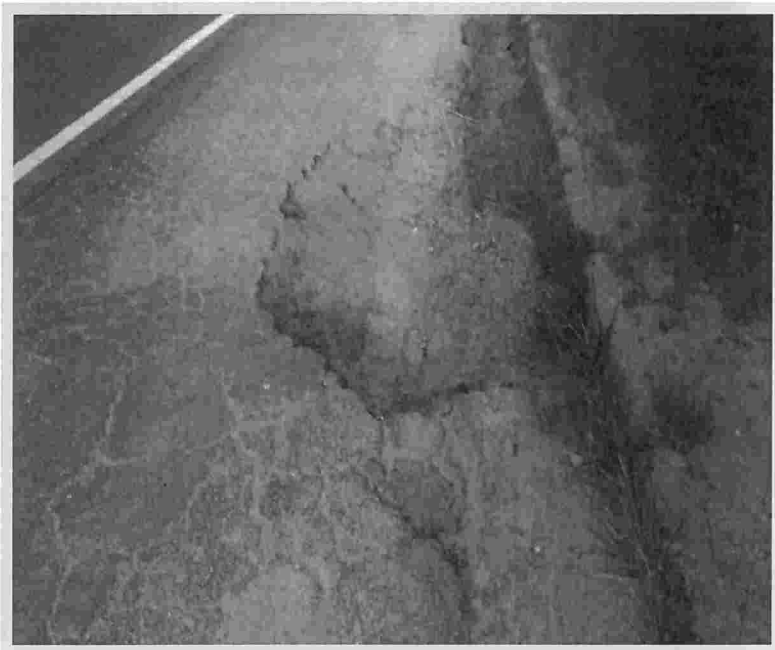
Foto 38 – SP 125 – Km 56,950m – Sentido Sul.
