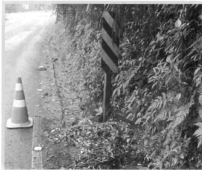
Foto 30 – SP 125 – Km 80,400m – Sentido Sul.
