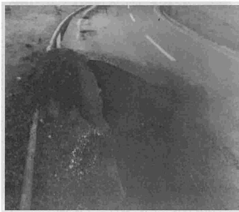
Foto 10 – SP 062 – Km 159,600m – Sentido Leste.
