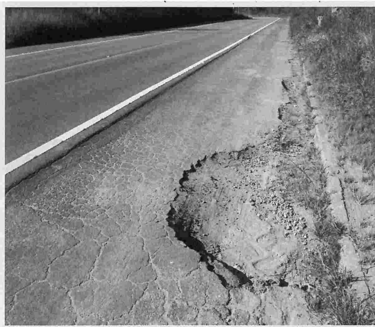
Foto 40 – SP 125 – Km 57,000m – Sentido Sul.
