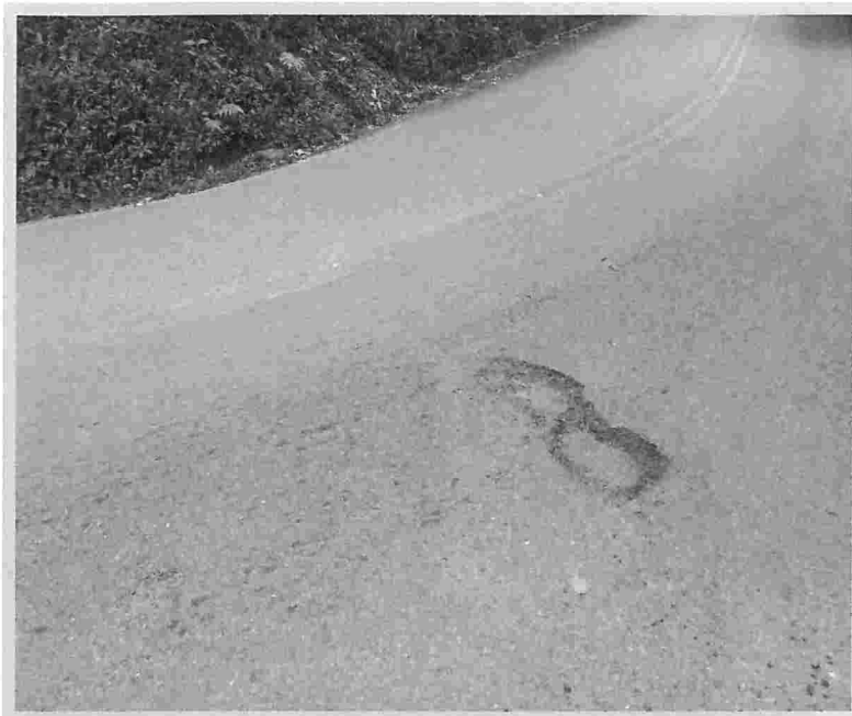
Foto 35 – SP 125 – Km 84,600m – Sentido Sul.
