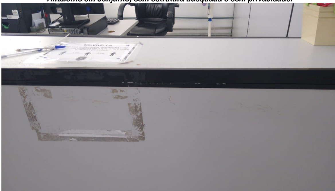
Balcão torto e em péssimo estado
