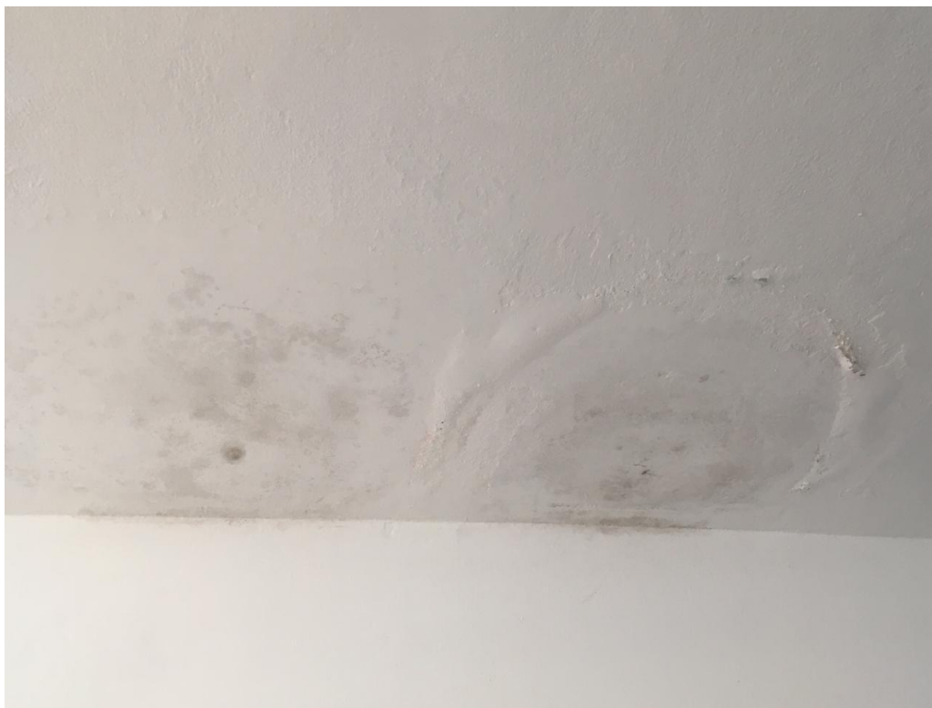
Infiltração embaixo da escada, visto na cozinha.
