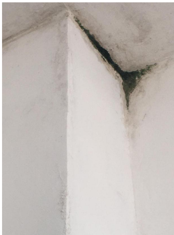
Infiltração na coluna da cozinha próximo a mesa.
