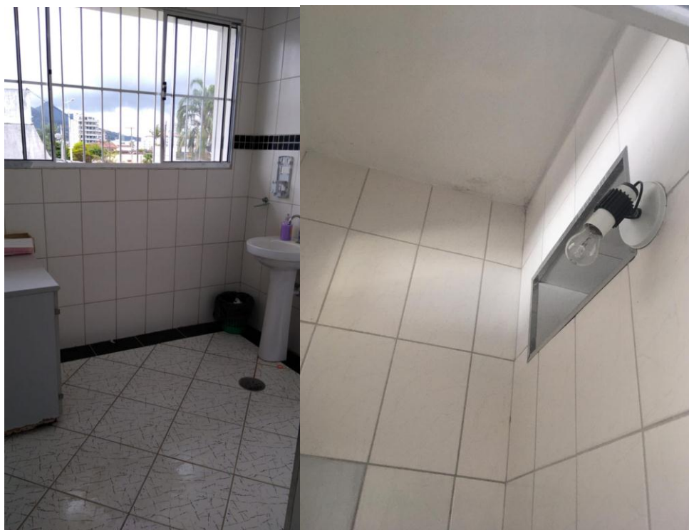
Gabinete de escritório no banheiro / Lâmpadas arcadas pelos funcionários e infiltrações.
