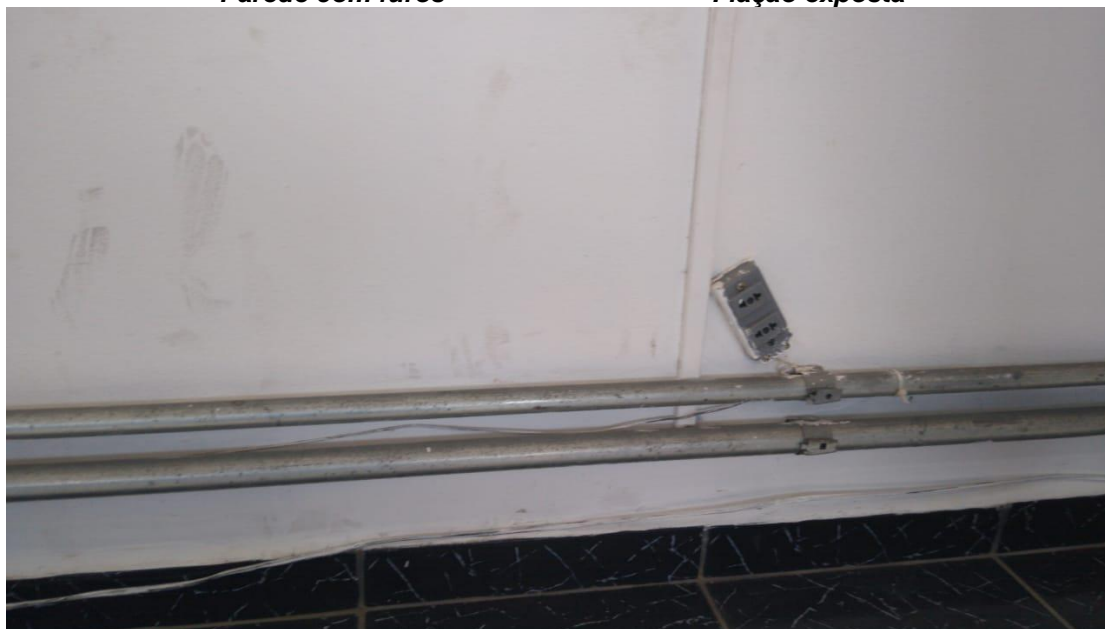
Parte elétrica antiga
