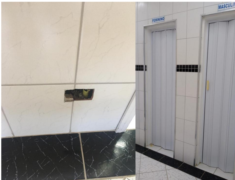
Caixa aberta / baias de vasos sanitários feminino e masculino.
