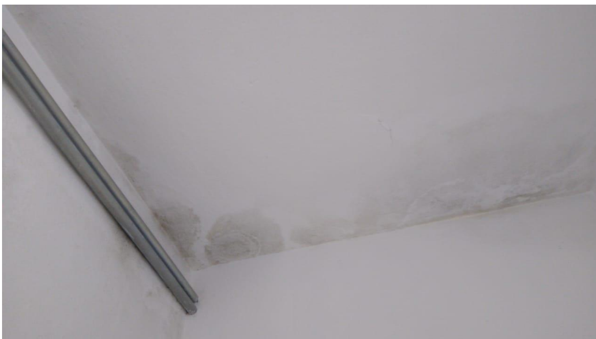
Infiltração no cartório central
