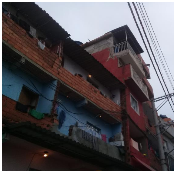
Sobreposição de imóveis, ausência de técnicas de engenharia.
