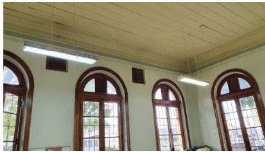
Forro danificado sala de aula
