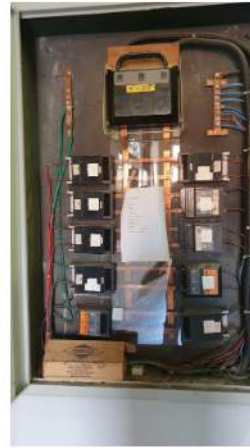
Quadro de força - entrada
