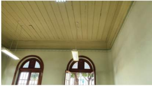
Forro danificado sala de aula
