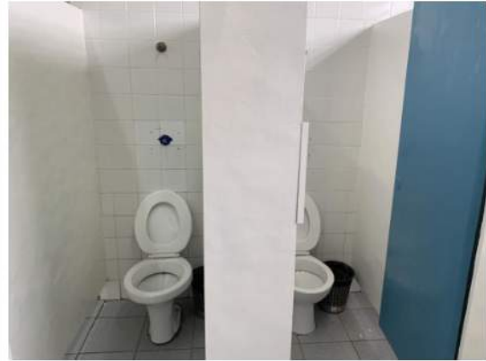
Esgoto - Louças Sanitárias
