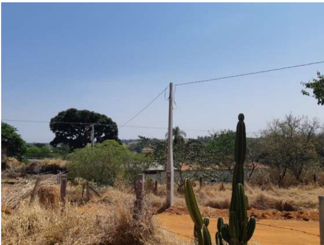
Figura 9 - Padrão de entrada de energia e fiação ligada à torre de transmissão de dados.
