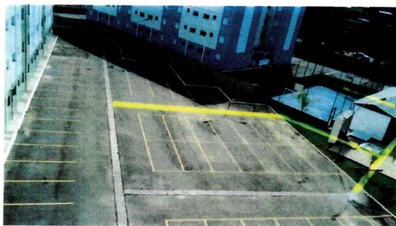
Flagrante de divergência entre o projetado e o executado na obra
