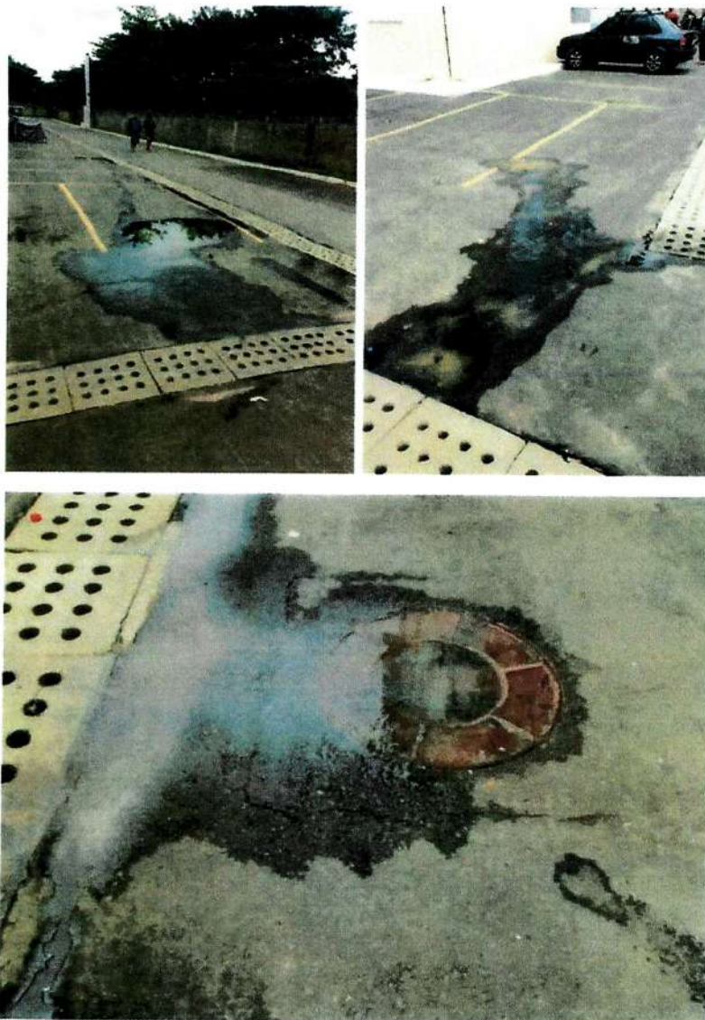
Imagens do esgoto sanitário transbordando dos poços de visita para a rede de drenagem dentro dos condomínios
