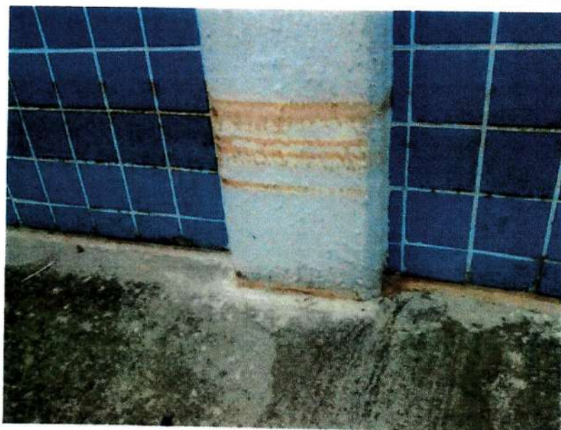
Imagens das marcas deixadas nas paredes pela a inundação dos condomínios na enchente de Fevereiro de 2019.
