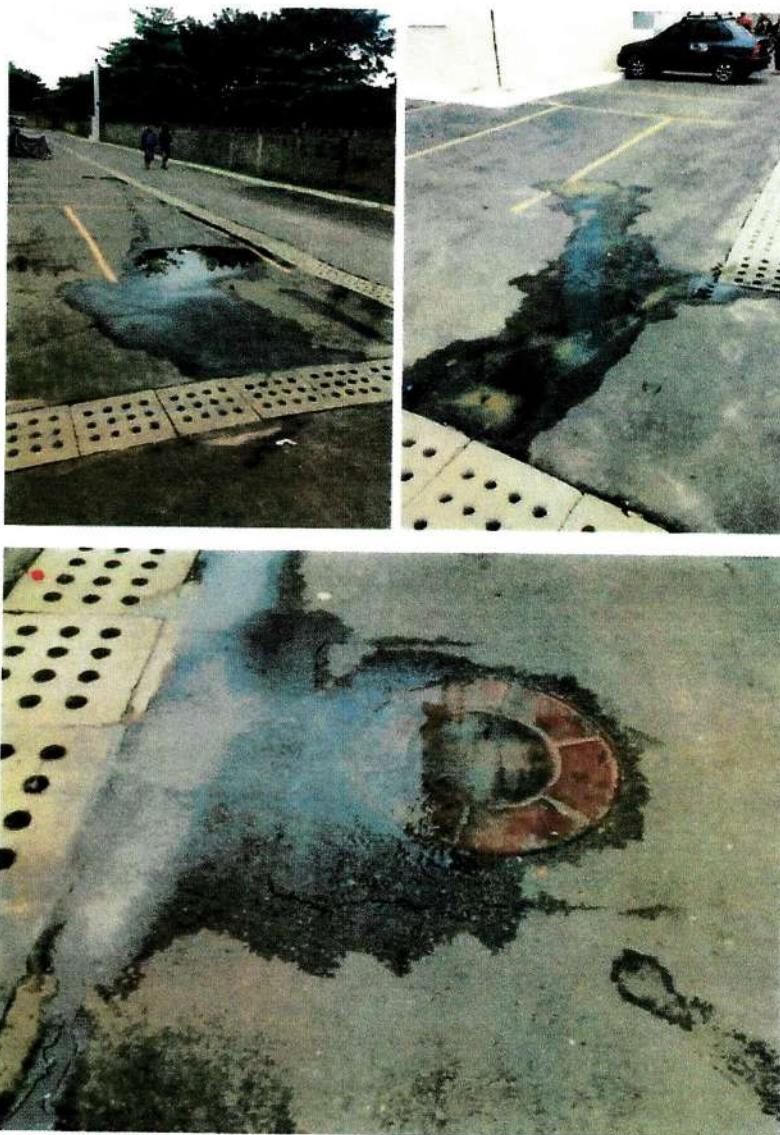
Imagens do esgoto sanitário transbordando dos poços de visita para a rede de drenagem dentro dos condomínios
