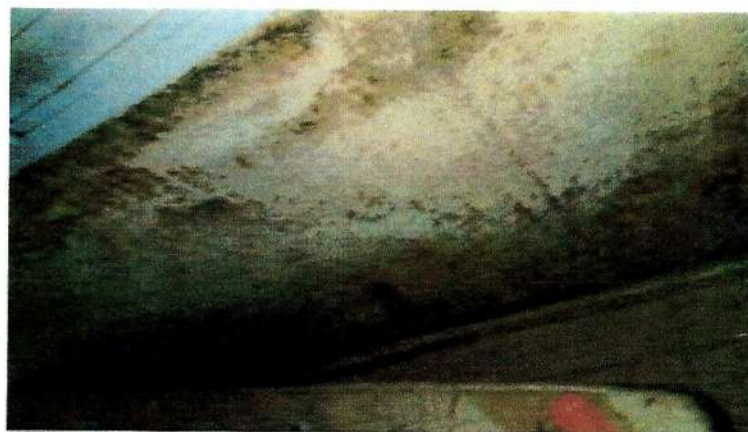
Imagens de problemas construtivos no interior dos apartamentos
