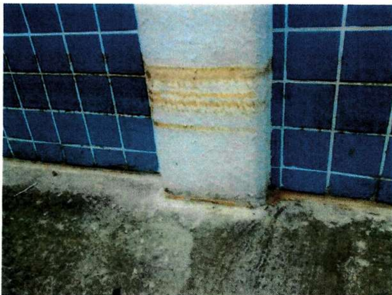
Imagens das marcas deixadas nas paredes pela a inundação dos condomínios na enchente de Fevereiro de 2019.
