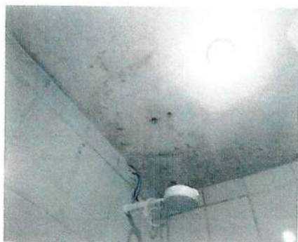
Foto 5 - Bloco B apto 28: Vazamento no teto do banheiro
