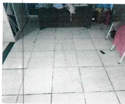
Foto 8 - Bloco B apto 28: Piso trincado e deslocando no dormitório 2
