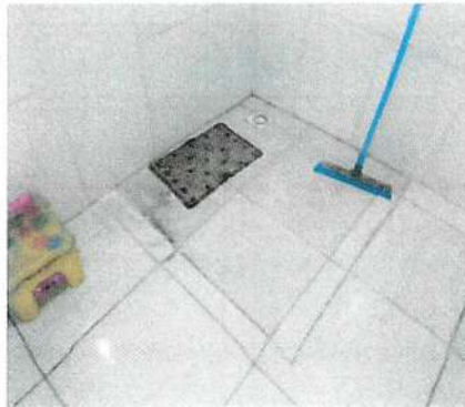
Foto 3 - Bloco A apto 52: Piso fissura e diferença de tonalidade.
