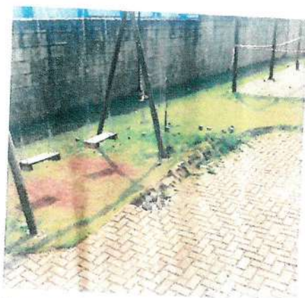
Foto 28 – Lote 3: Vista da área de lazer com piso intertravado solto e apresenta movimentação
