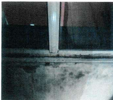
Foto 11 - Bloco C apto 47: Infiltração na janela do dormitório
