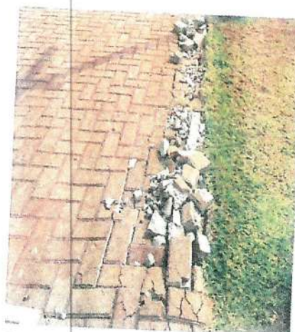
Foto 31 – Lote 3: Outro local da área de lazer com piso intertravado solto
