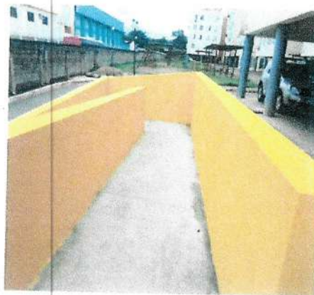
Foto 37 – Lote 3: Falta a instalar o corrimão na rampa
