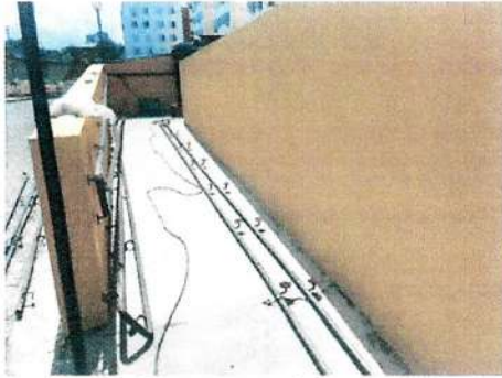
Foto feita hoje da rampa e muro de acesso cuja pendência é tida como atendida pela contratada na resposta que deu em nov/2021.
