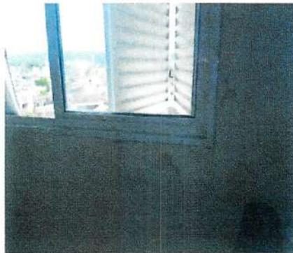
Foto 1 - Bloco A apto 52: Infiltração pela janela na parede do dormitório
