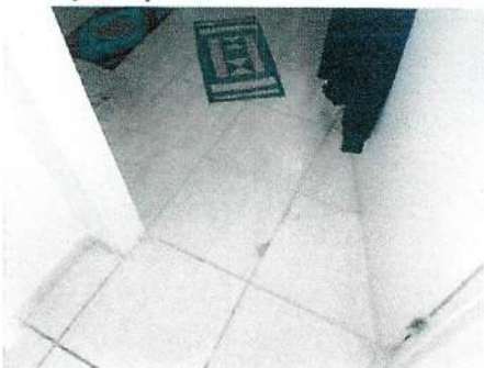
Foto 13 - Bloco C apto 27: Piso trincado e deslocamento das peças cerâmicas
