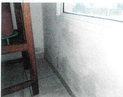
Foto 16 - Bloco D apto 4: Umidade na parede abaixo da janela
