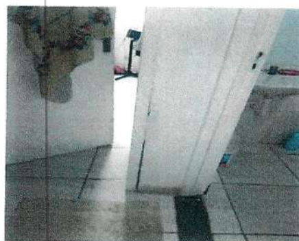
Foto 6 - Bloco B apto 28: Batente da porta do quarto solto
