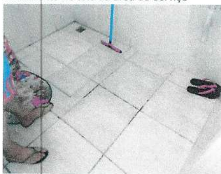
Foto 14 - Bloco C apto 27: Deslocamento e fissura nas peças cerâmicas do banheiro
