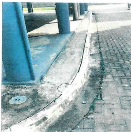
Foto 32 – Lote 3: Destacamento da guia
