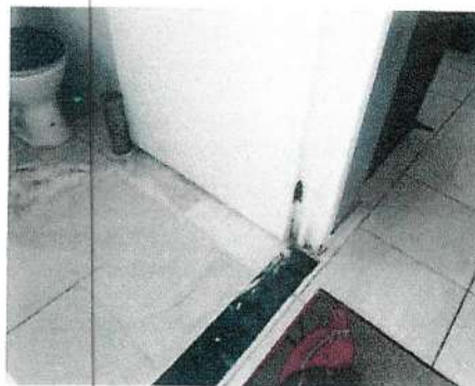
Foto 10 - Bloco B apto 28: Batente da porta danificado
