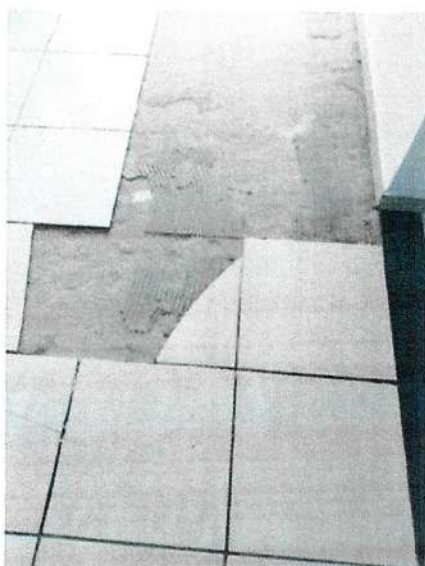
Foto do piso estufado, com deslocamento e cacos soltos afastados para evitar fermentos.
