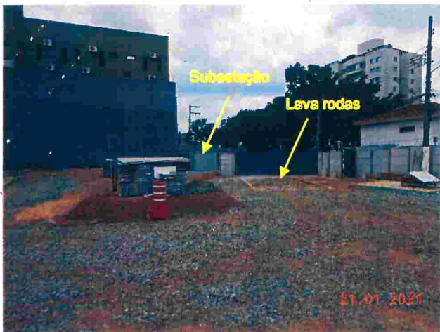
Figura 18: Lava rodas e subestação de energia para a obra da estação Vila Formosa (Lote 1).
