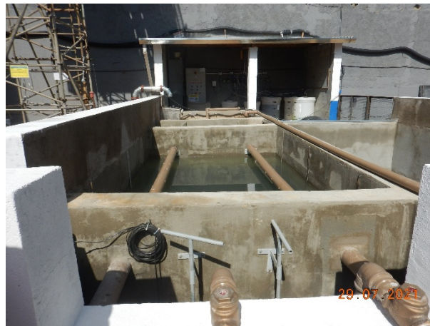
Figura 9: Sistema de tratamento de efluentes das atividades da obra.
