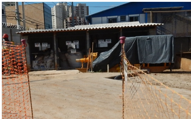
Figura 6: Bacias para depósito temporário de resíduos.
