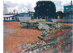
Figura 15: Áreas para depósito temporário de resíduos no canteiro da estação Vila Formosa (Lote 1).
