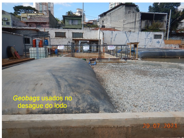
Figura 4: Estação de tratamento de efluentes das atividades da obra.
