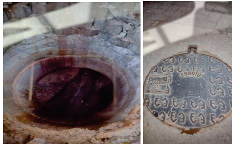
Fotos 1 e 2 – Rede de Esgoto em operação normal
