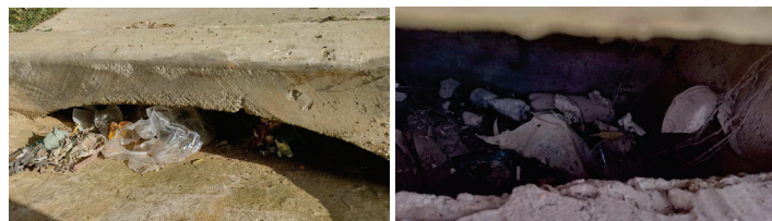
Fotos 3 e 4 – Galeria de Águas Pluviais e Boca de Lobo obstruídas
