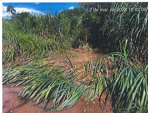
Imagem 5: Obstrução de galerias pluviais por vegetação
