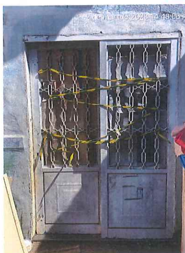
Imagens 26, 27 e 28: Residência unifamiliar interditada pela Defesa Civil e Departamento de Obras e Engenharia.
